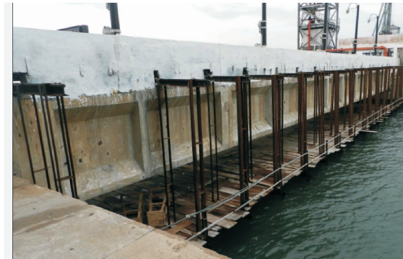
चित्र : वीपीटी के अपतट टैंकर टर्मिनल के पाट 3 के डिस्ट्रेसड पीएससी गिर्डर की जांच की गई
