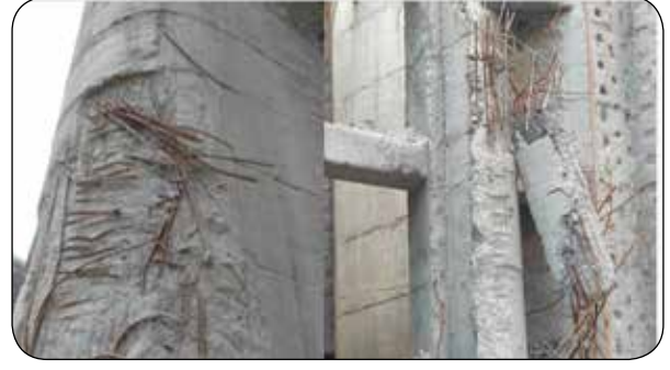
बैराज पियर और इंटेक स्ट्रक्चर को नुकसान
